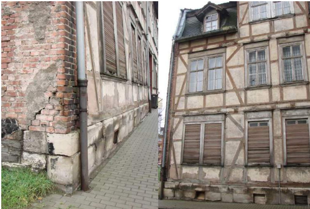
Abbildung 52: Problemlerstand in der Freiheitsstraße - Konstruktive Schäden der Fachwerksfassade- Gründerzeit
