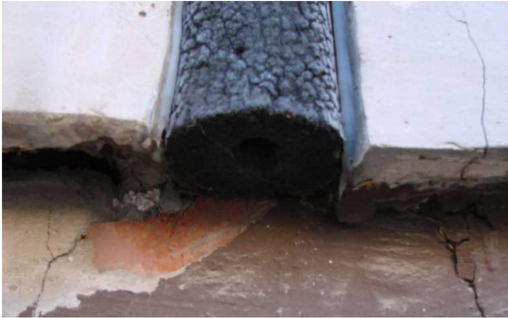
Abbildung 101: Verschlissener Fugenverschluss Waschsichtbetonelemente Löwentorstraße
