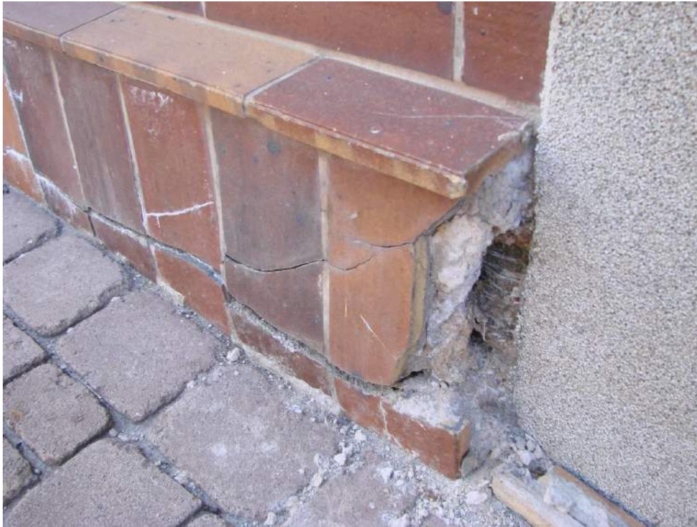
Abbildung 79: Schadensbilder im Untersuchungsgebiet - Problem Fachwerksockel in der Bahnhofstraße
