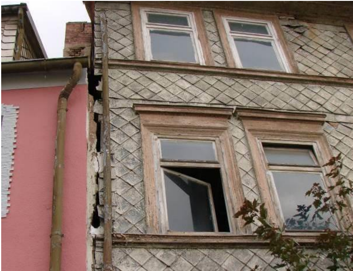
Abbildung 37: Weberstraße 11/12, Gefahr durch unsaniertes Nachbargebäude (Quelle: Holz)
