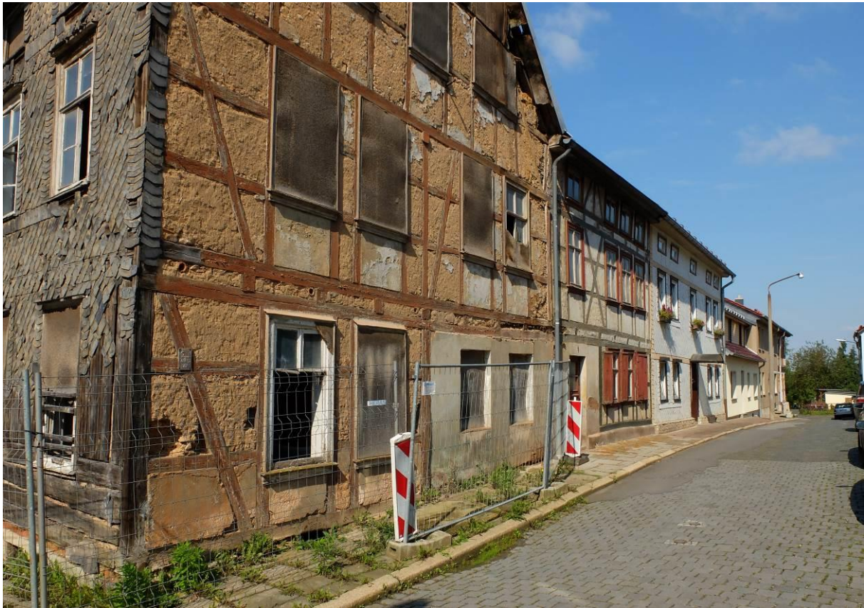
Abbildung 45: Leerstand Oberstraße - Hauptstraße (Quelle: DSK)
