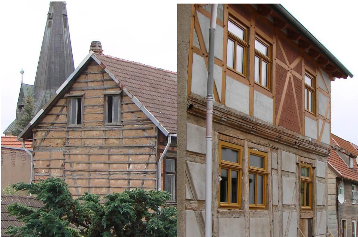
Abbildung 103: links: Lehmausfachungen ohne Schutz, Rückseite Hauptstraße; rechts: Sichtfachwerk in der Sanierungsphase, Oberstraße (Quellen: Holz)
