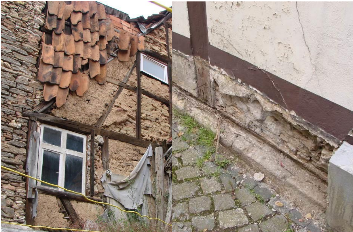
Abbildung 66: Fachwerk-Schadensbilder (Quellen: Holz)
