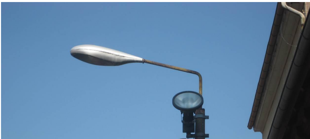
Abbildung 80: Leuchtenkopf, Hauptstraße (Quelle: DSK)
